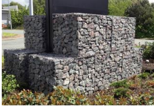
Figure 17 : Exemple de muret en gabion
